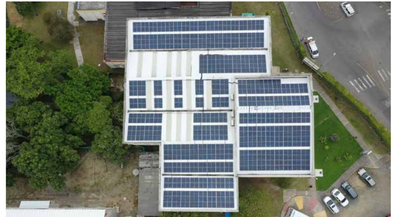
Universidad Tecnológica de Pereira / 2.070 Paneles Solares / 600,3 kWp Potencia Instalada
