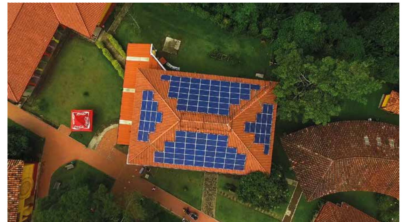
Liceo Pino Verde / 114 Paneles Solares / 30,78 kWp Potencia Instalada
